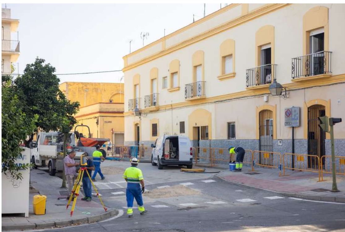
Vista de las viviendas afectadas por las obras en plaza del Carbón, en una imagen de archivo. MANU GARCÍA
